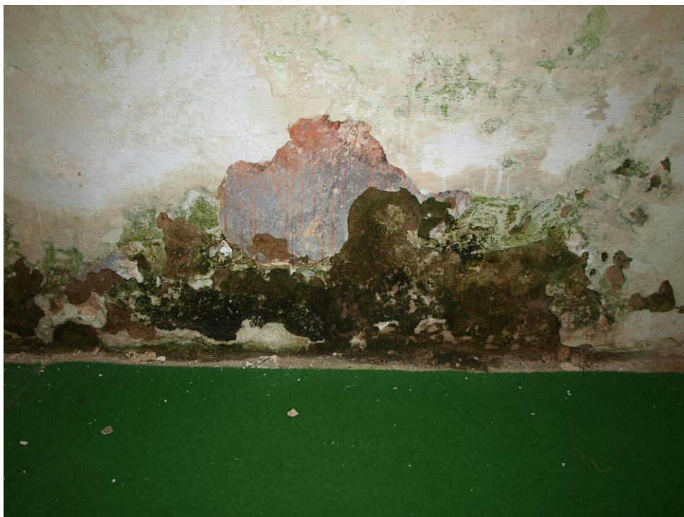
Obr. č. 22: Poškození omítkové vrstvy soklové části. V místech poškození jsou vidět barevné nátěry.
