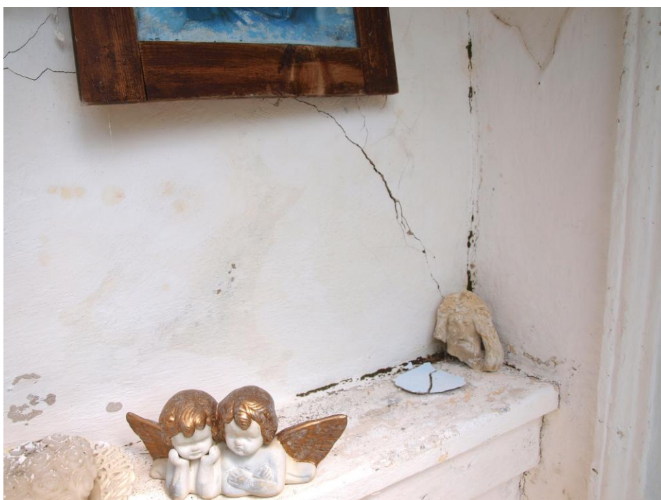
Obr. č. 117: Detail poškození.
