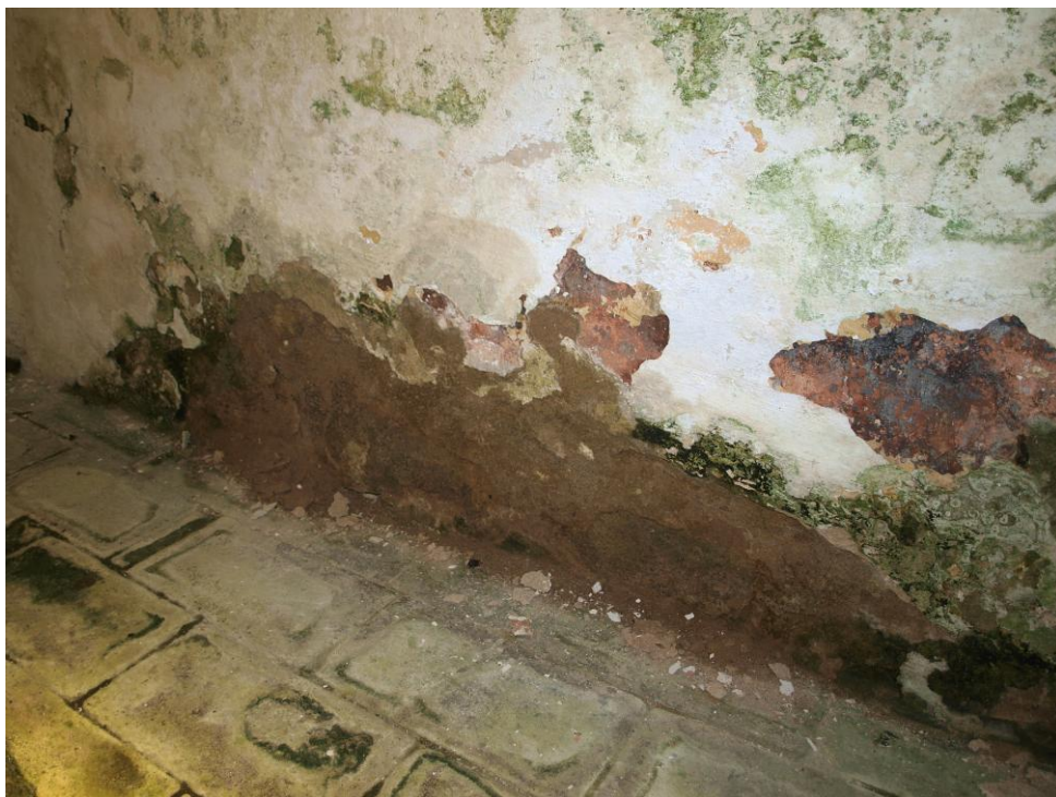
Obr. č. 24: Jižní stěna polygonálního závěru. Poškození omítkové vrstvy v soklové části.
