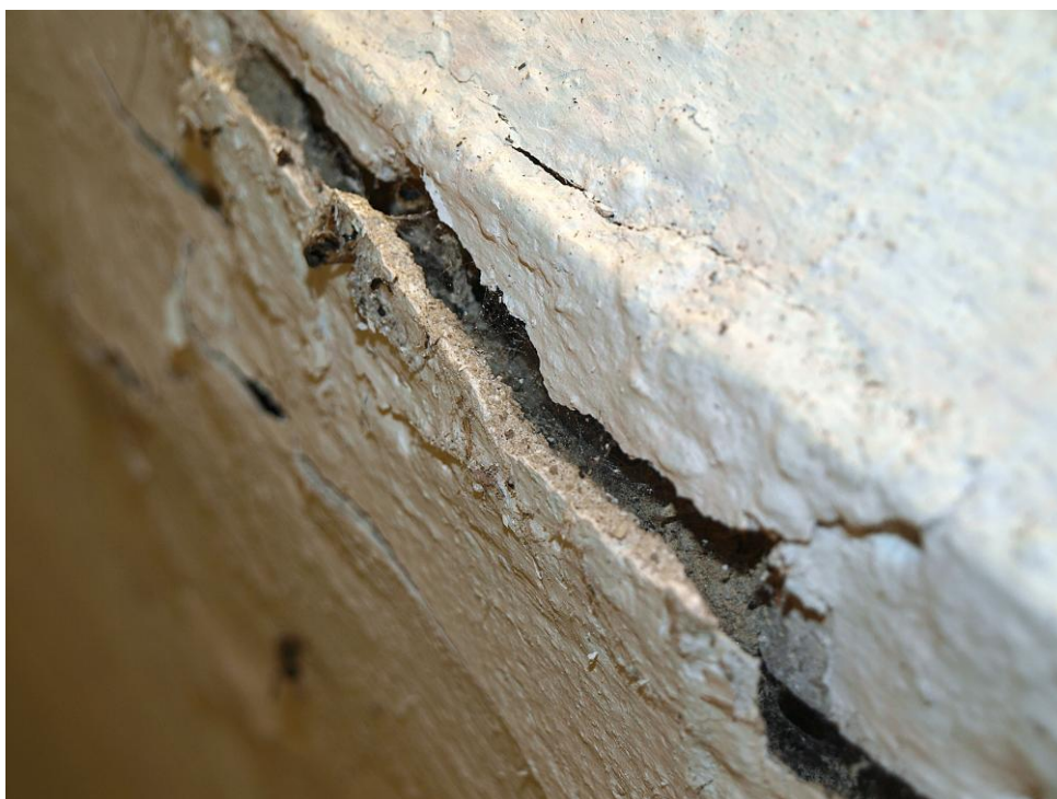
Obr. č. 31: Detail poškození.
