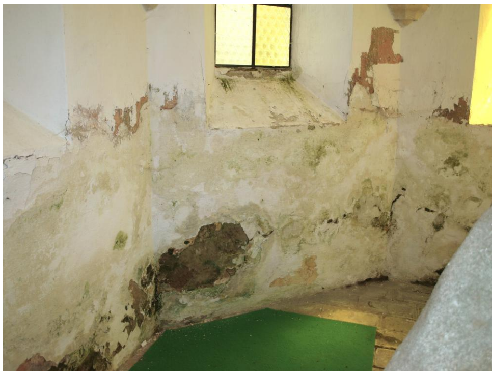
Obr. č. 14: JV stěna kaple. Detail poškození omítek.
