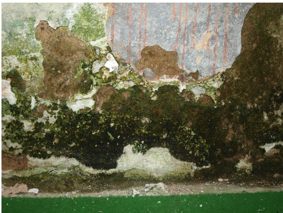
Obr. č. 23: Omítková vrstva poškozená vzlínající vlhkostí a pokryta organickými povlaky.
