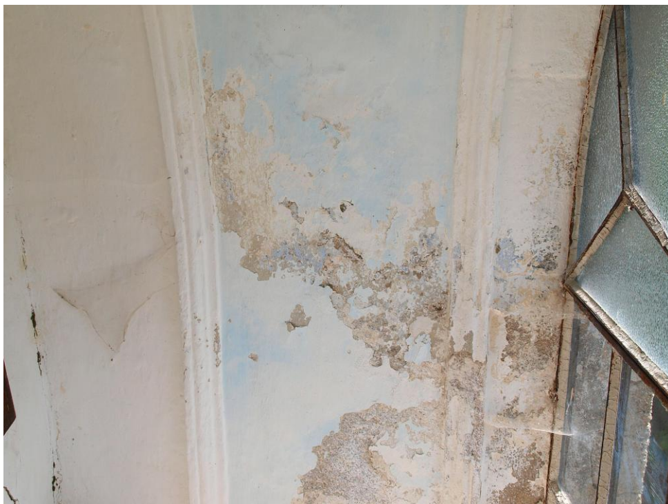
Obr. č. 110: Východní stěna kaple, poškození omítkové vrstvy s barevnými nátěry.
