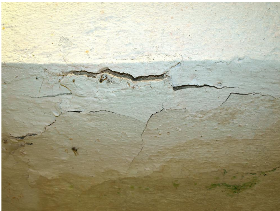
Obr. č. 30: Hrana okenního parapetu. Pohled na uvolněnou část omítkové vrstvy.
