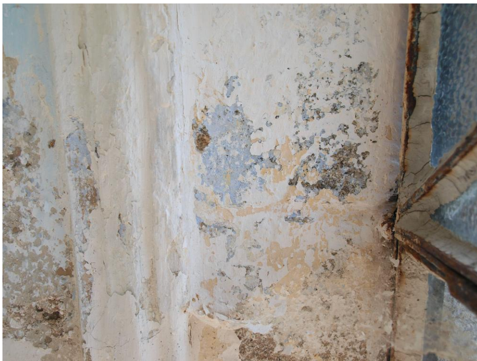
Obr. č. 114: Pohled na poškozené souvrství mladších barevných nátěrů kaple.
