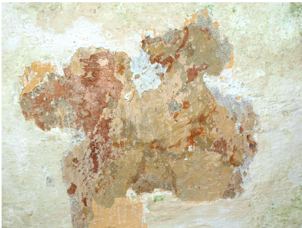
Obr. č. 77: V sondě je odkryta část poškozené malby iluzivního mramorování.
