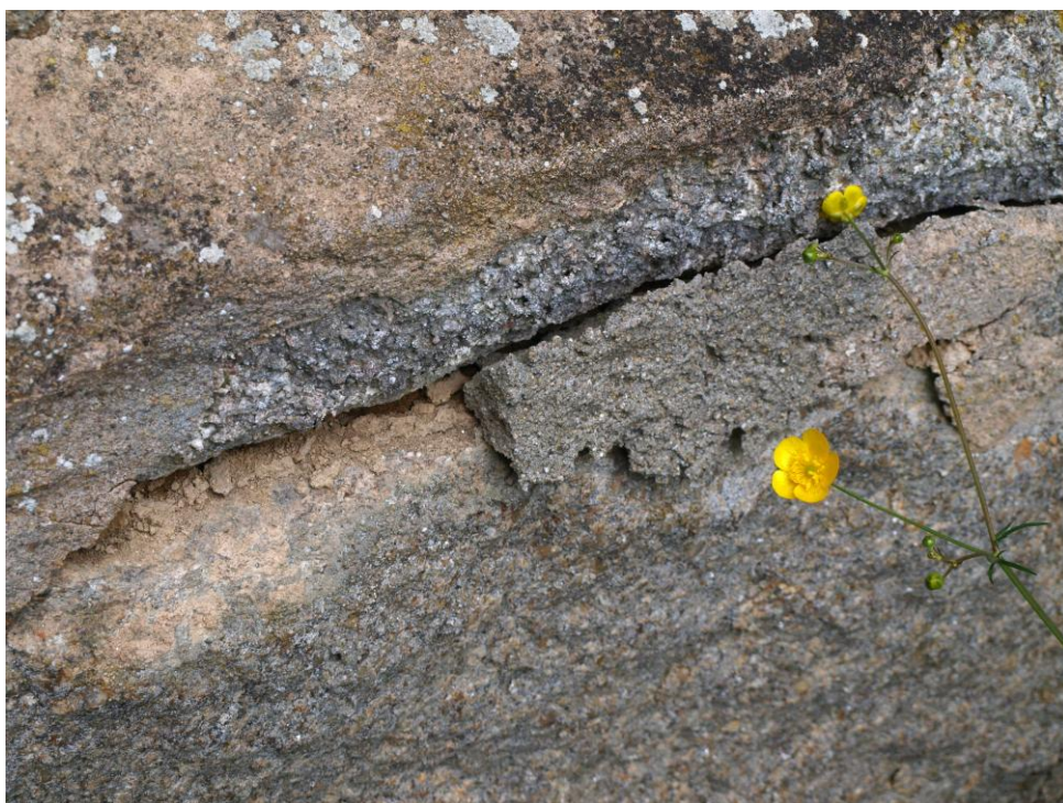
Obr. č. 103: Detail poškození. Novodobá oprava spárování šedou cementovou maltou.
