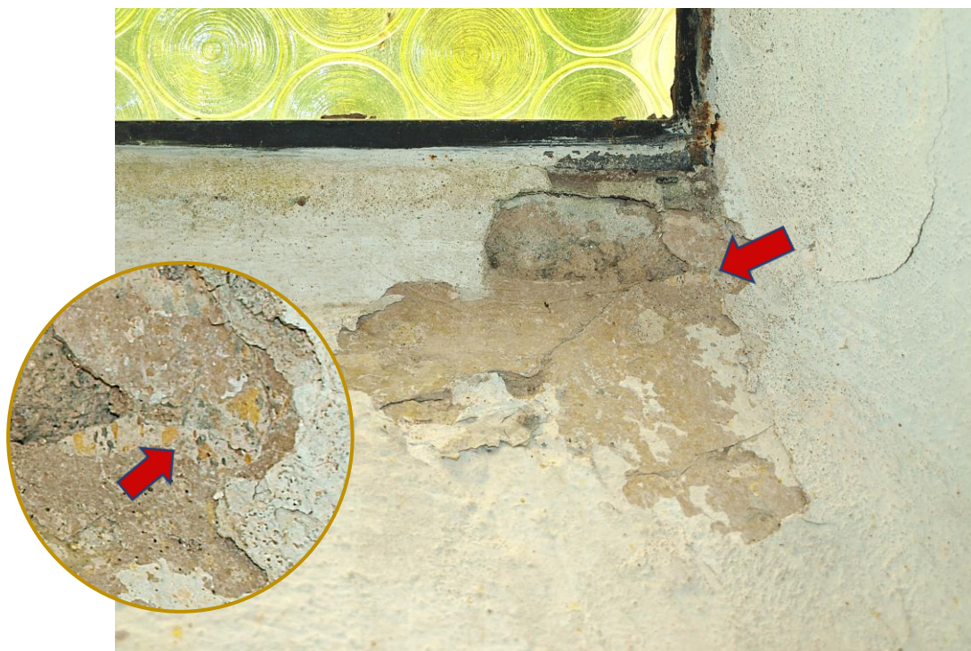
Obr. č. 28: Poškození původní omítkové vrstvy v okolí kovových ráků oken. Na omítkové vrstvě je částečně dochovaná nejstarší barevná úprava kaple (označeno šipkou) z roku 1890.
