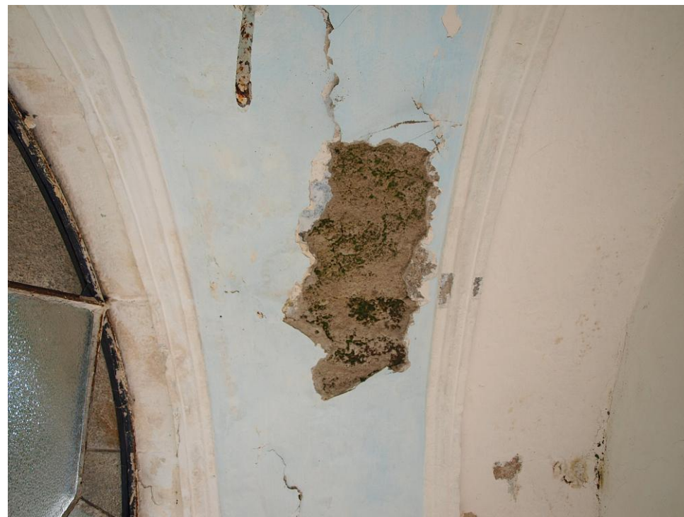
Obr. č. 109: Detail poškození omítkové vrstvy.
