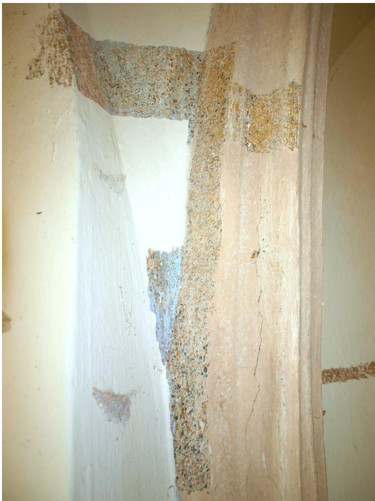
Obr. č. 40: Celkový pohled na pásovou sondu. Cákance jsou provedeny celoplošně bez dalšího členění stěn (sokl, kvádrování).
