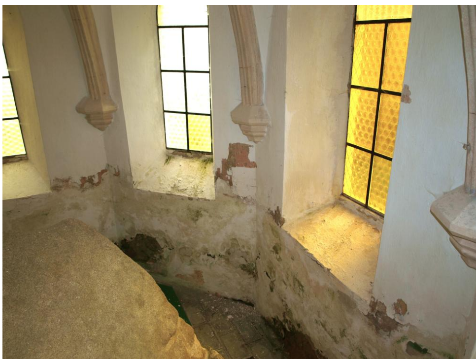
Obr. č. 15: Poškození omítek na JV a J stěně kaple.
