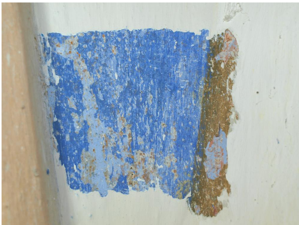
Obr. č. 57: Sonda na klenebním poli přecházející na plochu stěny. Malba modrého nebe navazující na monochromní nátěr zelené barvy.
