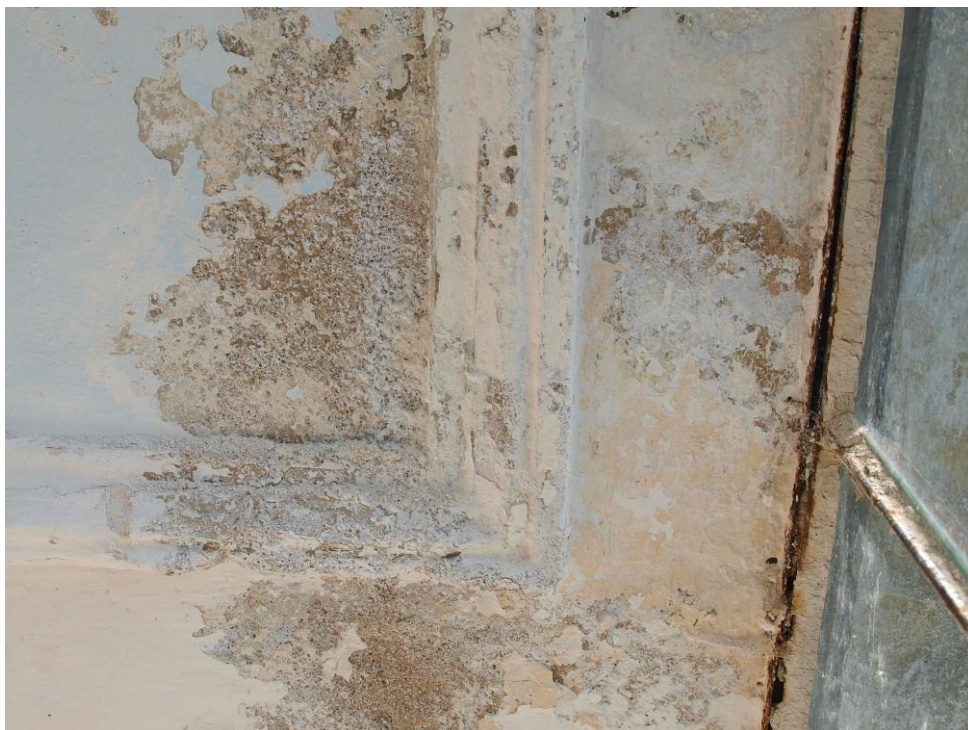
Obr. č. 111: Detail poškození, výkvěty solí.
