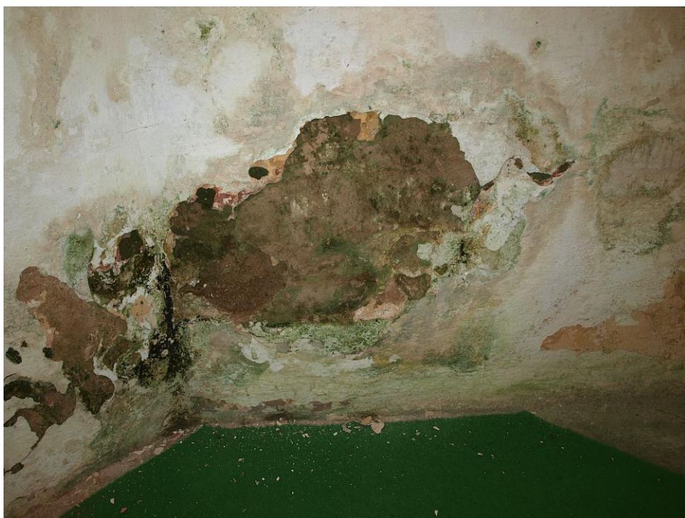
Obr. č. 21: Detail, výrazné poškození omítky způsobené vzlínající vlhkostí.
