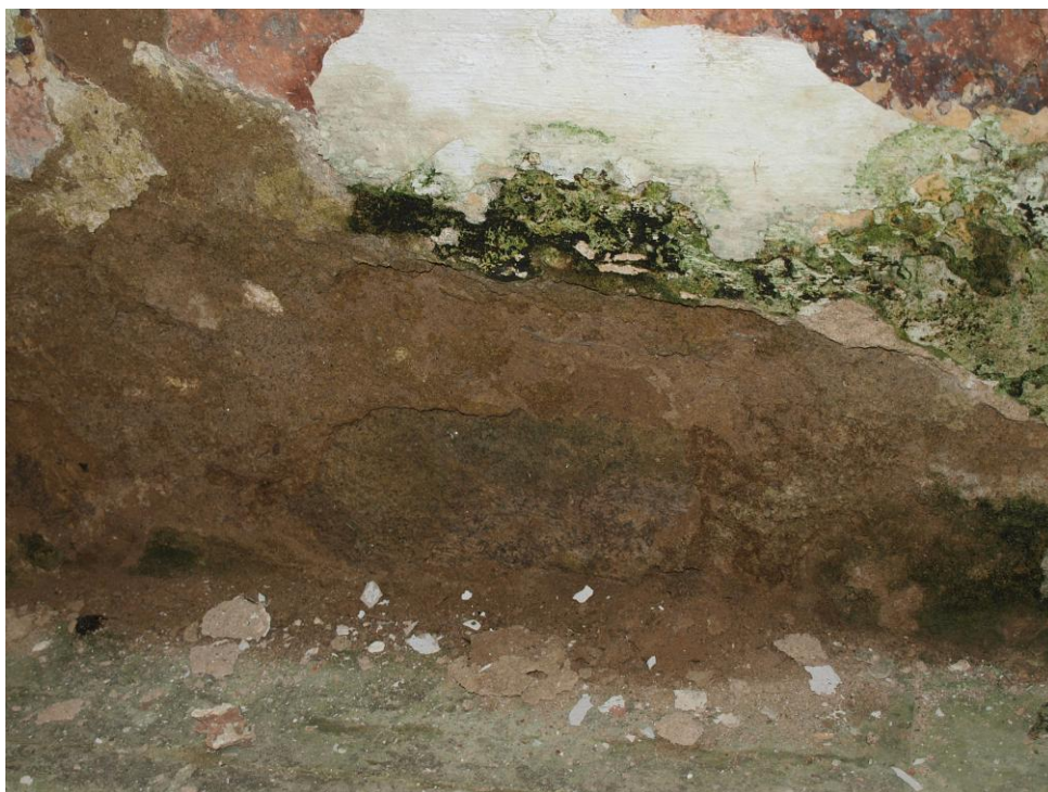
Obr. č. 25: Detail. Omítková vrstva opadaná až na kamenné zdivo.
