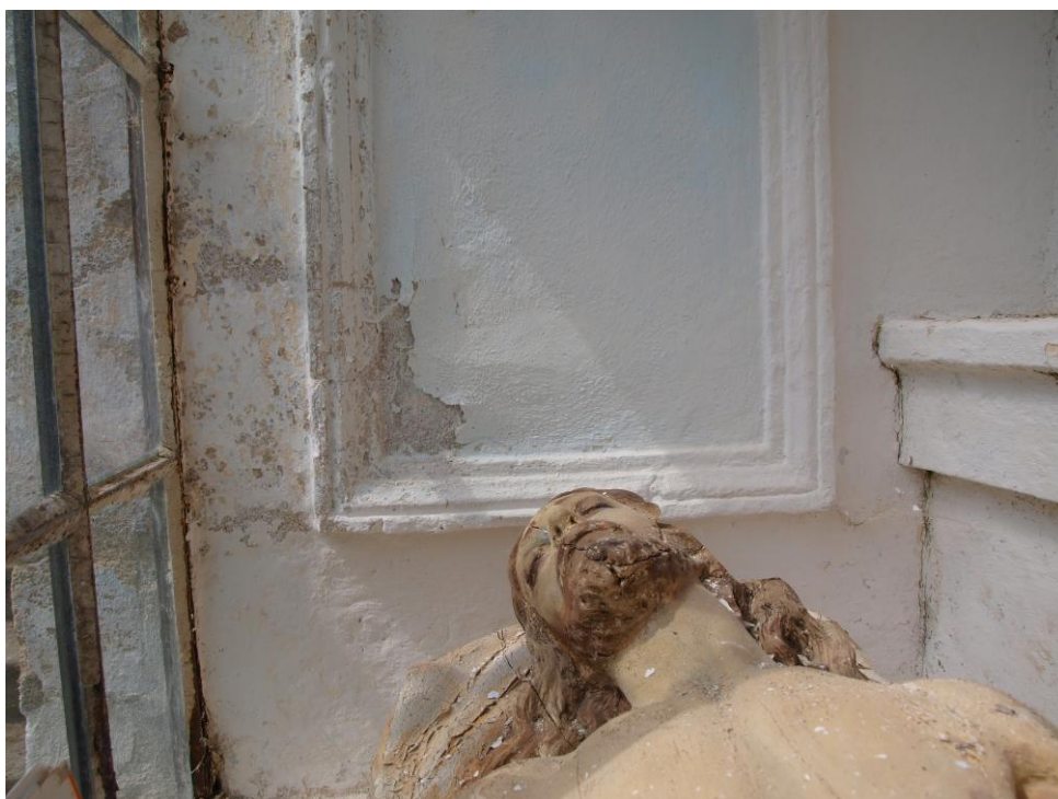
Obr. č. 107: Spodní část štukového zrcadla s poškozeným souvrstvím maleb.
