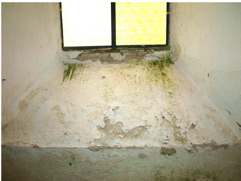
Obr. č. 27: Poškození omítkové vrstvy na parapetu okenního otvoru.
