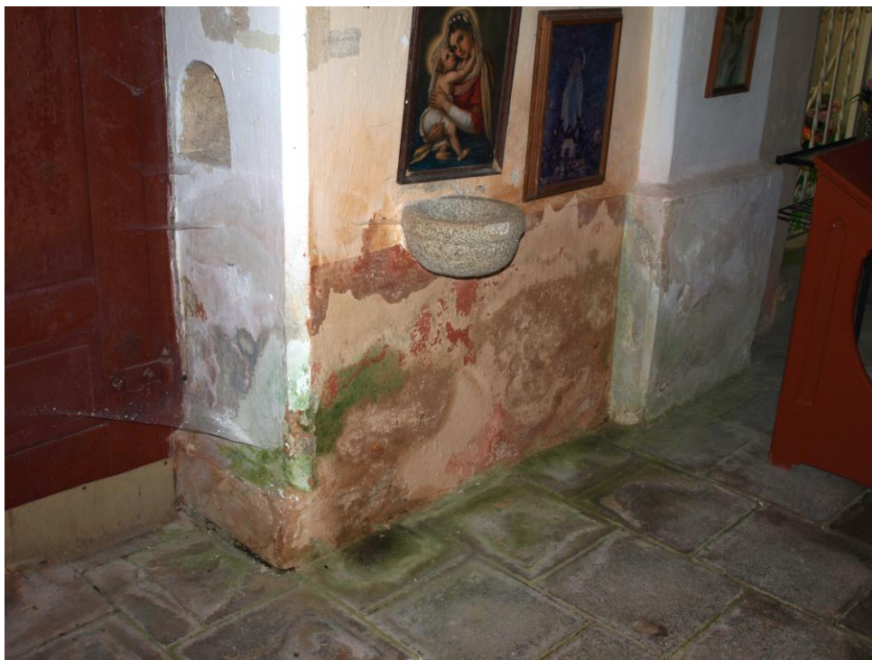
Obr. č. 94: Jižní stěna chodby. Poškození maleb v soklové části.
